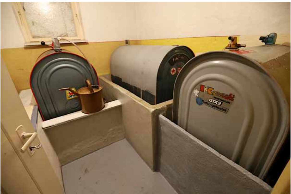
Lager Heizöl / Keller
